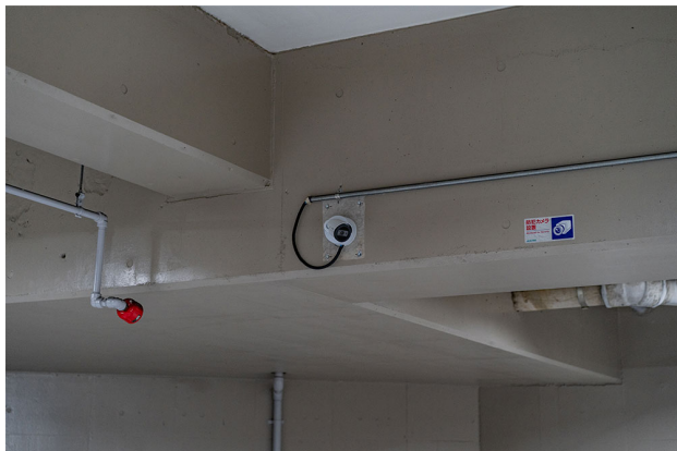
駐車場内には複数の防犯カメラが設置されている。
